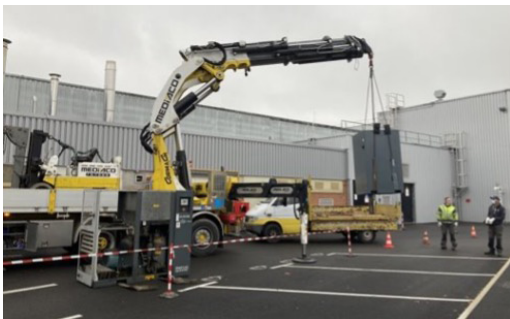
Livraison des nouveaux compresseurs d'air sur le site de Biscotte Pasquier Andrézieux
